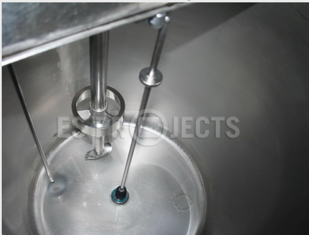
Vue interne - Cuve de Dosage
