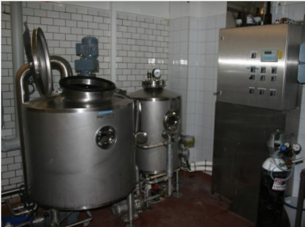
Cuve d ebulliton, chauffage extérieur, armoie de commande
