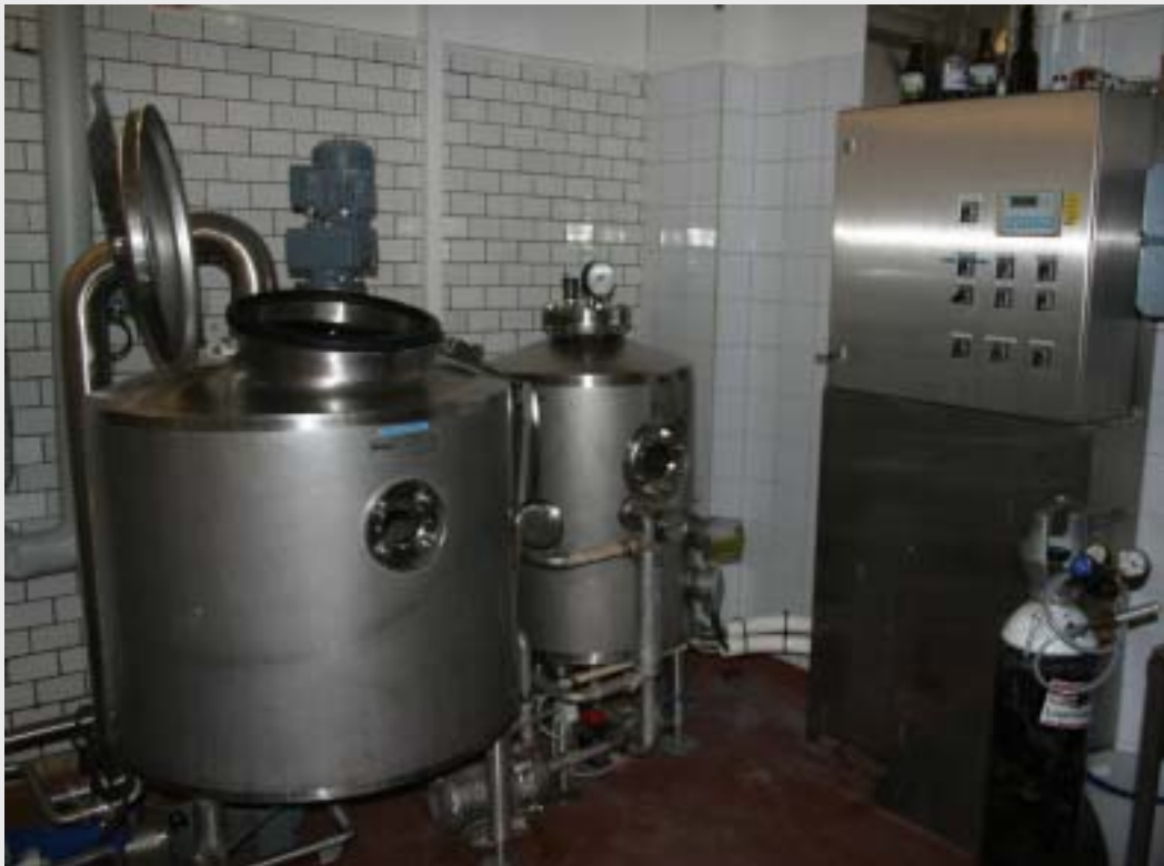
Paila de mosto, paila de cocción externa, armario de distribución
