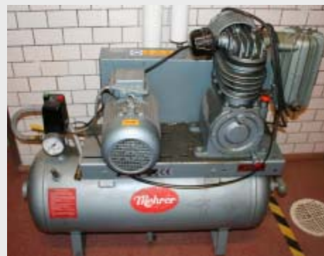
Compresor de aire
