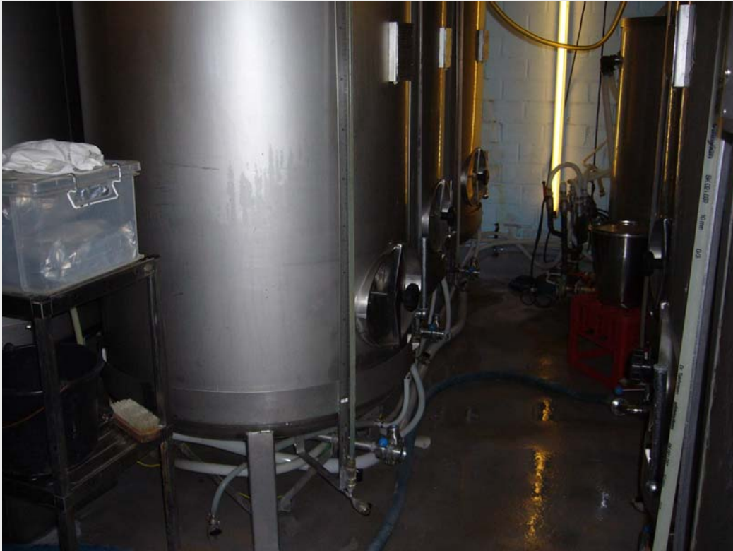
Cuve de maturation
