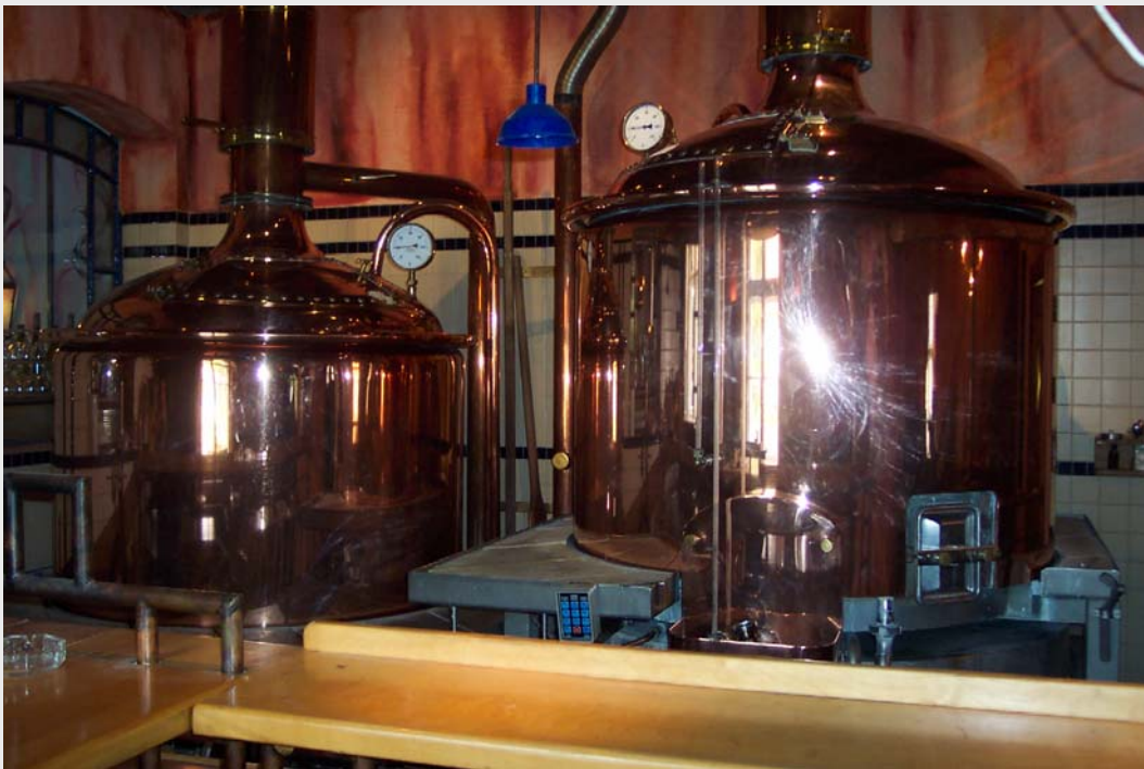
Salle de brassage - tuyauterie
