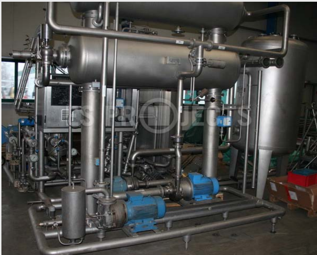
Module de dégazage
