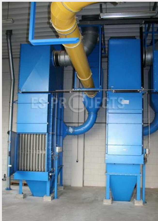
Installation de filtre à poche
