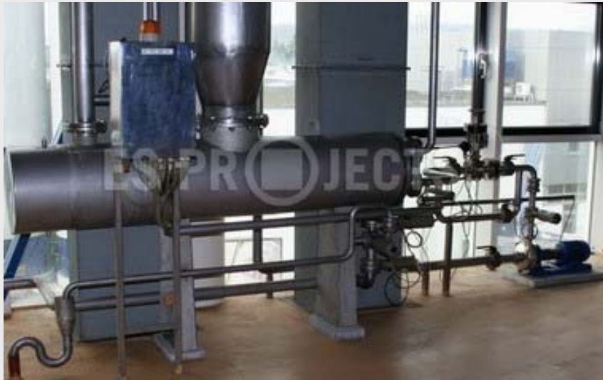
Condensateur de vapeur
