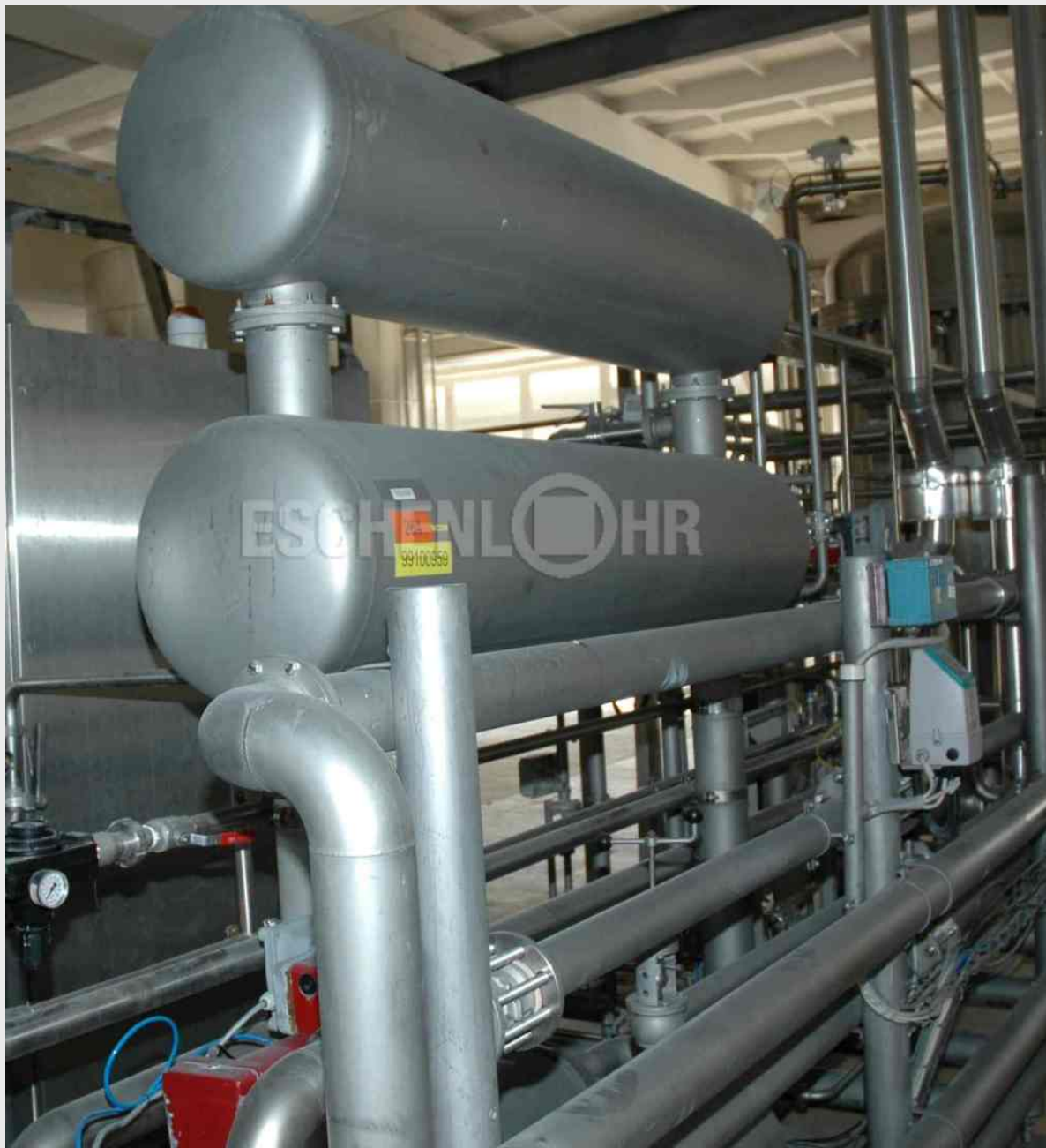
Установка дегазации воды
