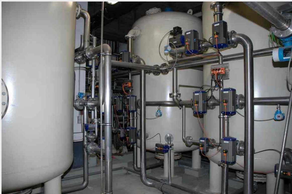
Equipo de desaceramiento
