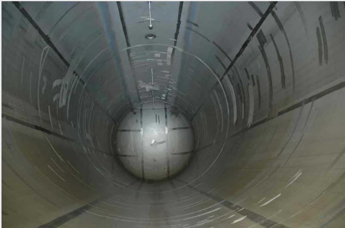
Tanques de reposo
