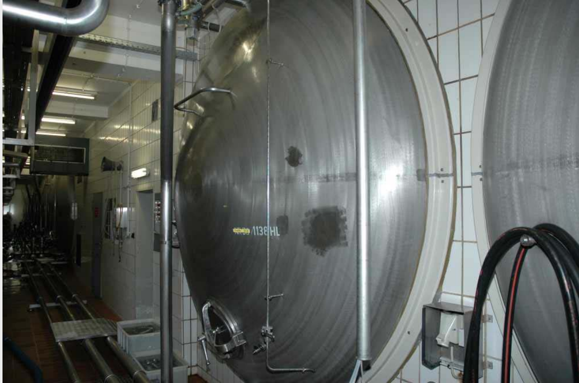
Tanques de reposo
