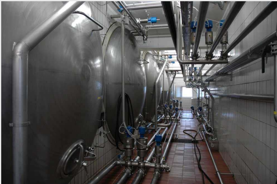
Tanques de reposo
